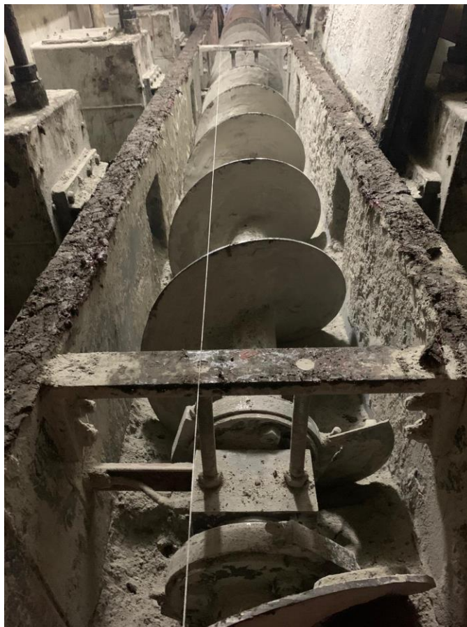
2. Rotor brodskog pužnog transportera tzv. filer pumpe cementa - mjerenje i analiza vibracija
